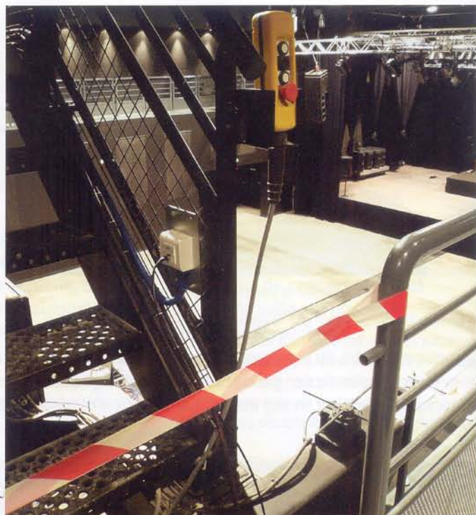
Commande électrique du mur de réduction de salle
